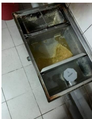
圖二、油水分離槽
