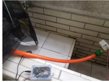
電磁開關閥和儲水槽的連接
