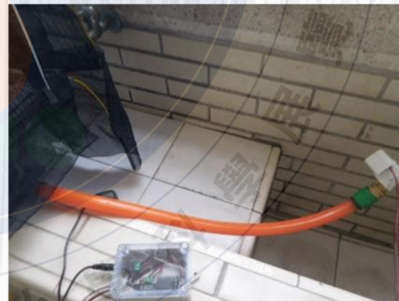
電磁開關閥和儲水槽的連接。
