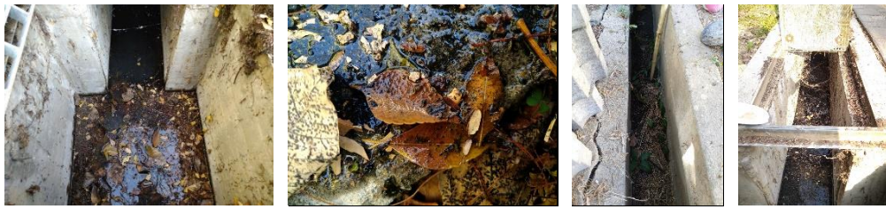
圖 2.水溝陰井 圖 3.陰井內多為腐爛的落葉 圖 4.乾水溝 圖 5.濕水溝 (德富館) (樂學樓)
