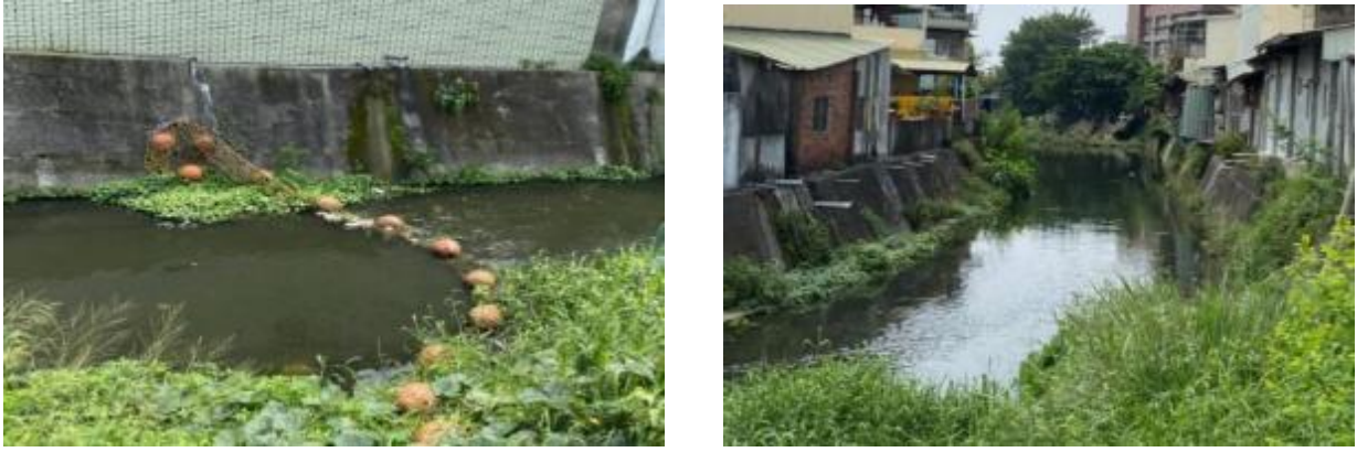
圖 8. 屏東基督教醫院周邊欠缺完善地下汙水處理系統
