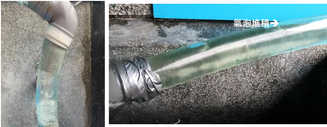
水管無法被填滿的狀況
