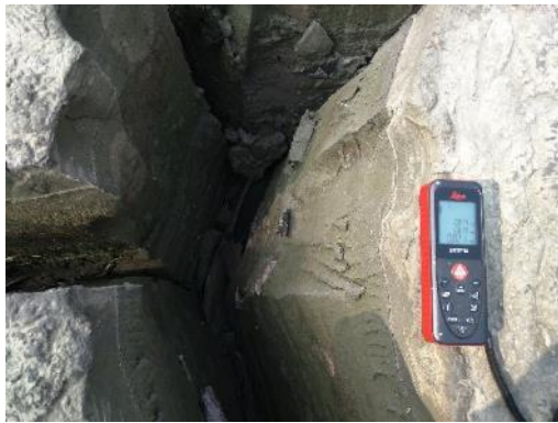
照片 40 泥裂的深度使用測距儀可以非常準確測量。
