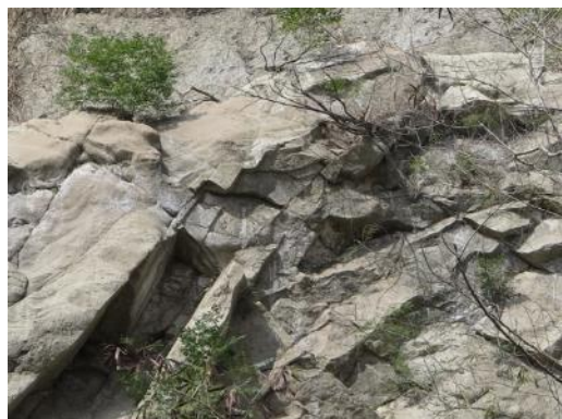
照片 28 農塘大壩下方也有明顯的厚層砂岩裂開，隱藏著許多小斷層。
