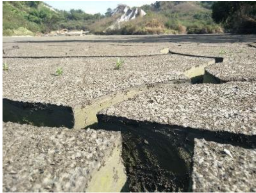
照片 38 泥裂的裂開的角度幾乎接近九十度。
