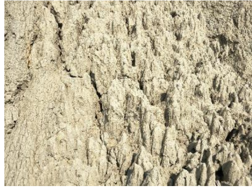
照片 16 大雨後的泥塊流移動到湖泊或河流將造成泥岩淤積。
